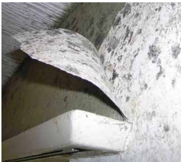
Figura 2: muffa sulla tappezzeria e sullo strato di intonaco sottostante (la muffa ha intaccato gli strati più profondi).
