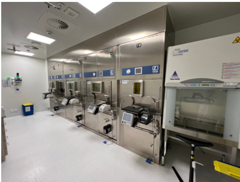
Figure 18 Les automates de synthèse et de remplissage de la radio-pharmacie se trouvent derrière les portes en acier chromé des cellules blanches blindées
