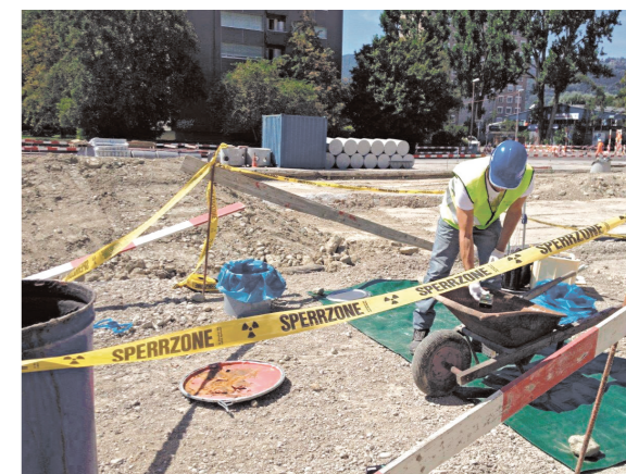
Figure 21 : Tri de déchets contaminés au radium-226 lors de travaux d'excavation dans l'ancienne décharge des Fléoles
