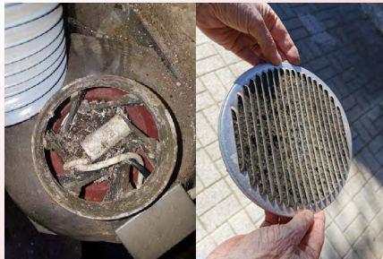
Entretien déficient des grilles et du ventilateur
