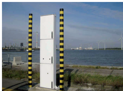
Figures 3 et 4 : Portiques de mesure des ports d'Anvers et de Rotterdam
