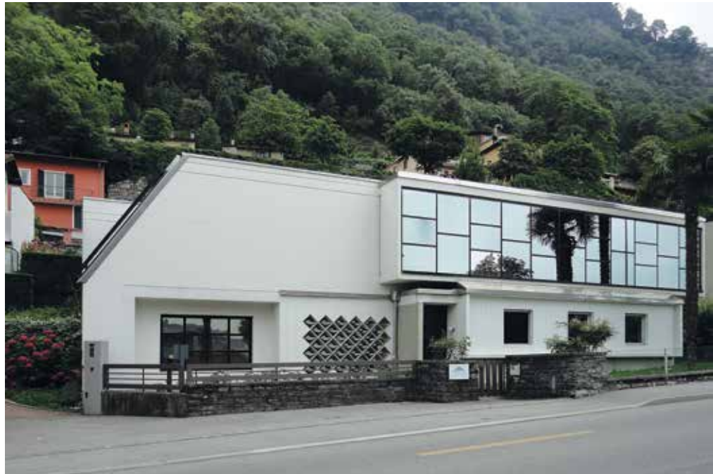
Abbildung 6.1 (oben): Das zweigeschossige Gebäude wies Undichtigkeiten in der Bodenkonstruktion auf. Das führte zu erhöhten Radonwerten, insbesondere im Erdgeschoss.
