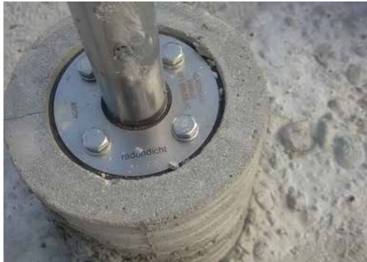
Abbildung 6.100: Eine radondichte Rohrdurchführung mit Flanschabdeckung.
