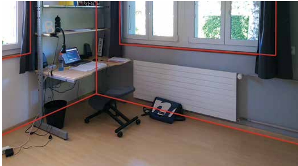
Abbildung 6.52: Um das einwandfreie Funktionieren des Systems gewährleisten zu können, müssten die Fugen auf insgesamt 25 m abgedichtet werden.
