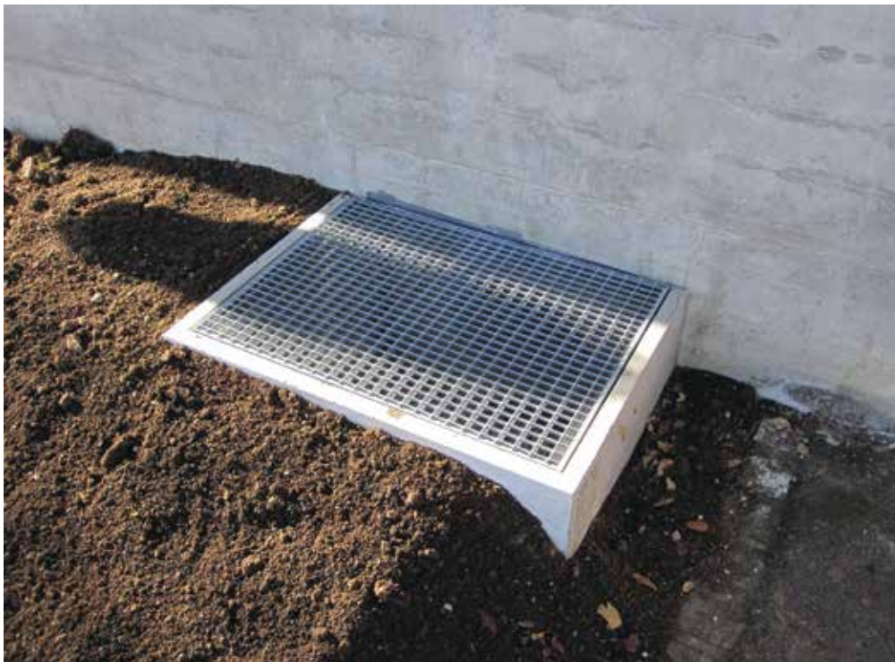
Abbildung 6.50: Anstelle eines Ausström- rohres bis zum Dach ge- langt die abgesaugte Luft über dieses Gitter ins Freie. Während des Betriebes be- trägt die Radonkonzentra- tion im Bereich des Gitters rund 4000 \text{ Bq/m}^3 .
