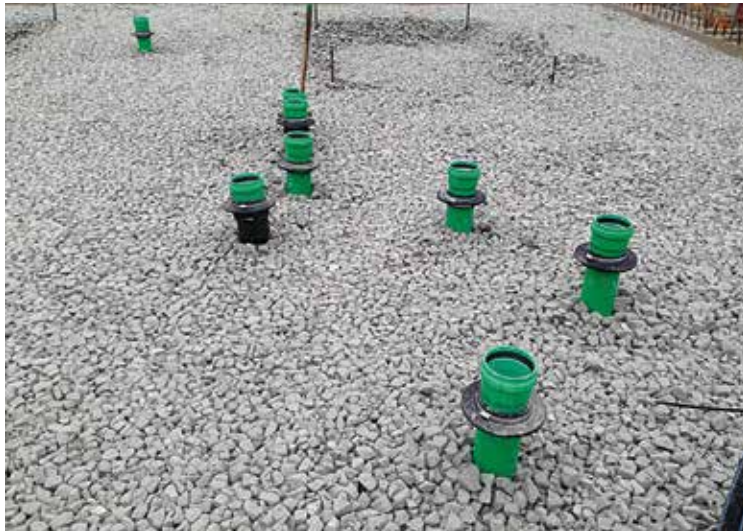
Abbildung 6.97: Eine Misaporschicht dient als Radondrainage.
