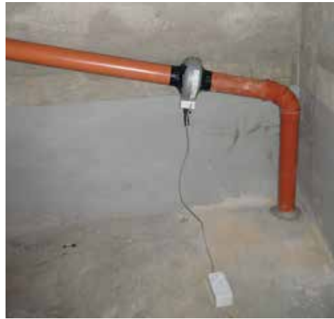
Abbildung 6.13: Zunächst wurde die Entlüftung des Kriechkellers getestet (links). Anschliessend wurde ein interner Radonbrunnen erstellt (rechts).
