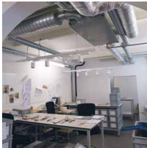
Abbildung 6.73: Die Räume im Untergeschoss werden zum Teil als Arbeitsräume benutzt (links). Rechts ist die Punktabsaugung der installierten Lüftung zu sehen.
