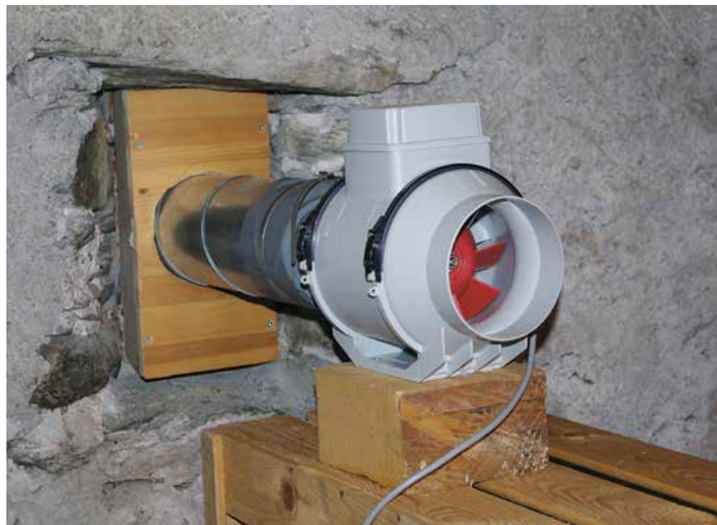
Abbildung 6.39: Mithilfe eines Ventilators wird die Luft aus dem Kellerraum mit dem naturbelassenen Boden ins Freie transportiert. Luft mit hoher Radonkonzentration kann somit nicht mehr in die Wohnräume gelangen.
