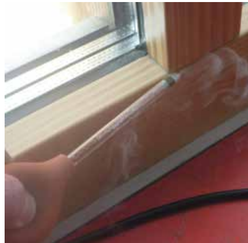
Abbildung 6.36: Zur Prüfung von Luftströmungen an typischen Leckstellen wurden Nebelröhrchen eingesetzt (InfraBlow.Siegrist GmbH).
