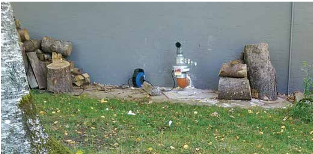
Abbildung 6.55: Temporäre Installation eines Radonbrunnens.
