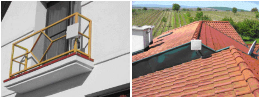
Abbildung 7 : WiMAX Sende-Empfangsanlagen an Hausfassaden oder Dächern. Quelle: 18
