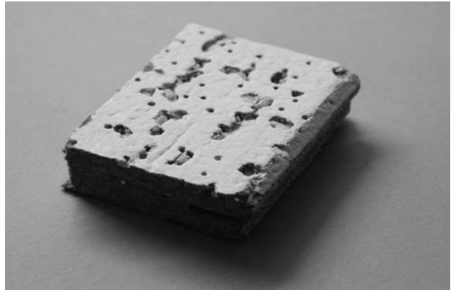
Teil einer asbesthaltigen Akustikplatte, Foto IST
