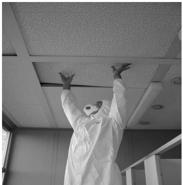
Asbesthaltige, abgehängte Deckenplatte (Akustikplatte), IST
