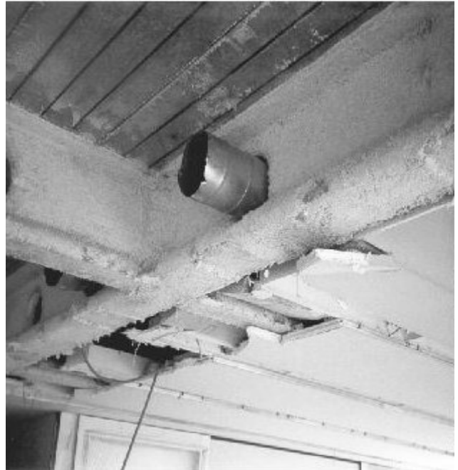
Spritzasbest an einer metallischen Tragkonstruktion, IST
