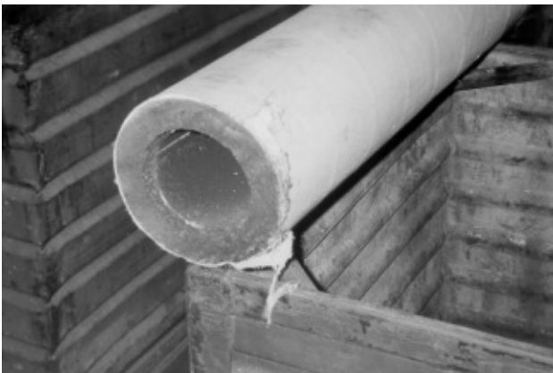
Asbesthaltige Rohrisolation, Foto IST
